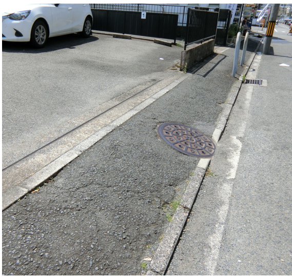
↑ 歩道と車道の高低差（傾斜）がきつすぎて、「危なくて歩けない歩道」になってしまってます。
